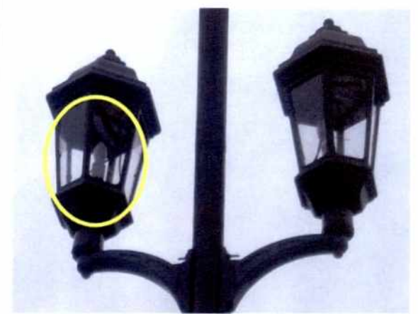
Fotografía N° 8: Ampolletas instaladas del tipo incandescente (corrientes)
